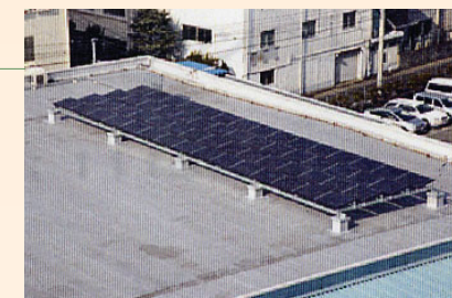
本社屋上に設置した太陽光パネル
